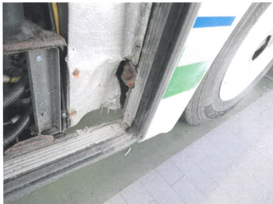
Bild 22 : Motorraum hinten rechts
