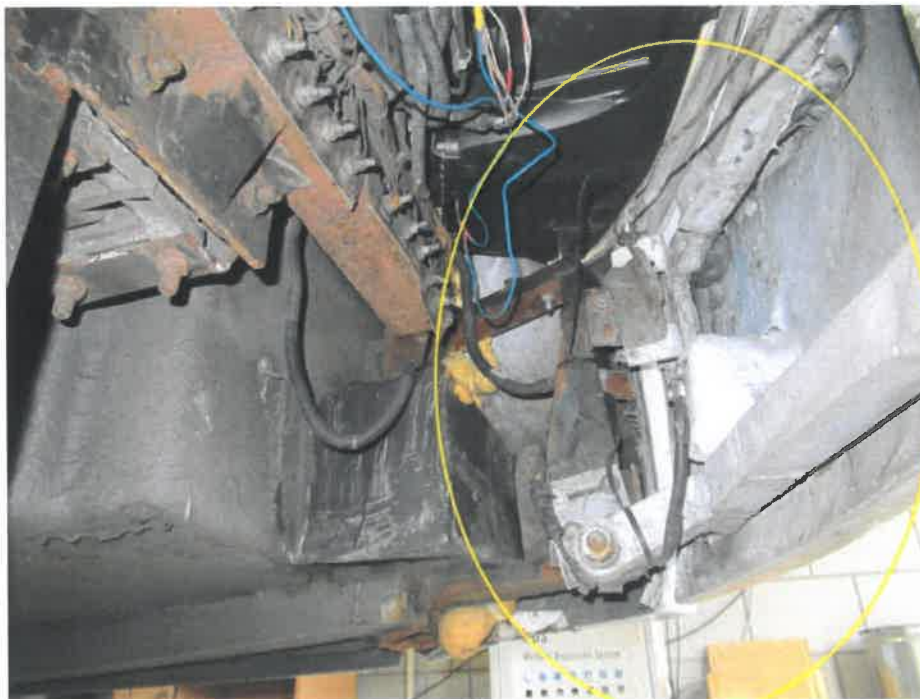
Bild 31 : nicht fachgerecht instandgesetzter Unfallschaden vorne links
