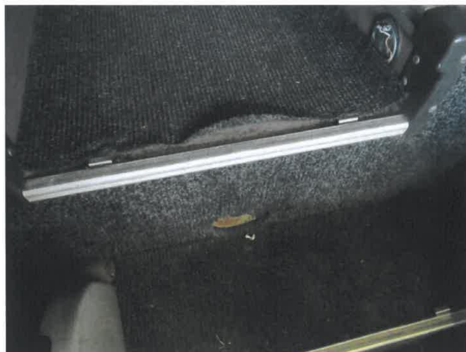
Bild 14 : Bodenbeläge teilweise aufgerissen/verschlissen
