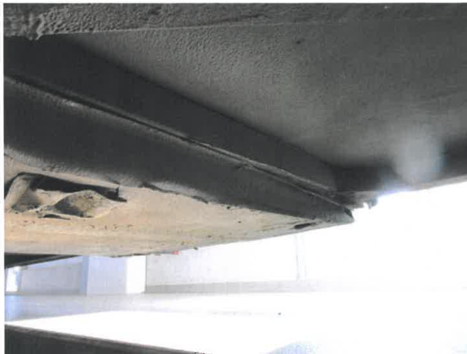
Bild 35 : Toilette stark verschmutzt/Unterboden deformiert
